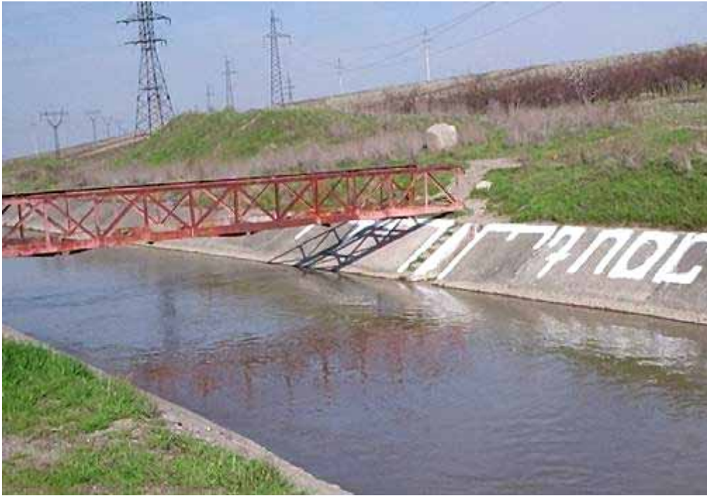
Гидропост на магистральном канале (ЮФМК)
