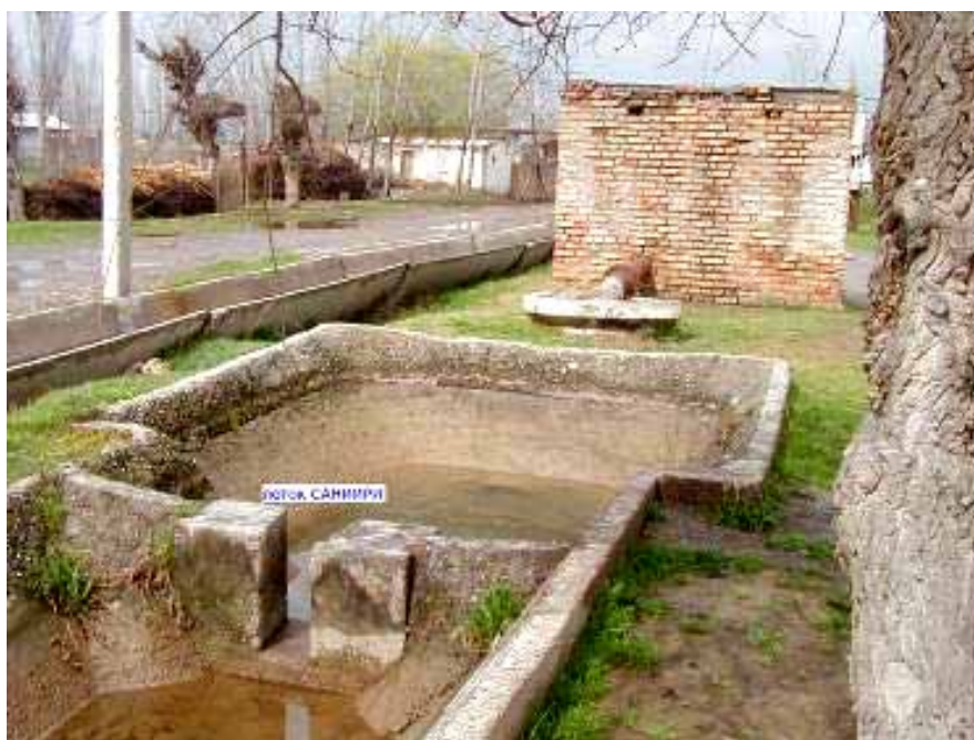
Рис.19. Приемный бассейн скважины вертикального дренажа оборудованного на выходе «ВЛС»
