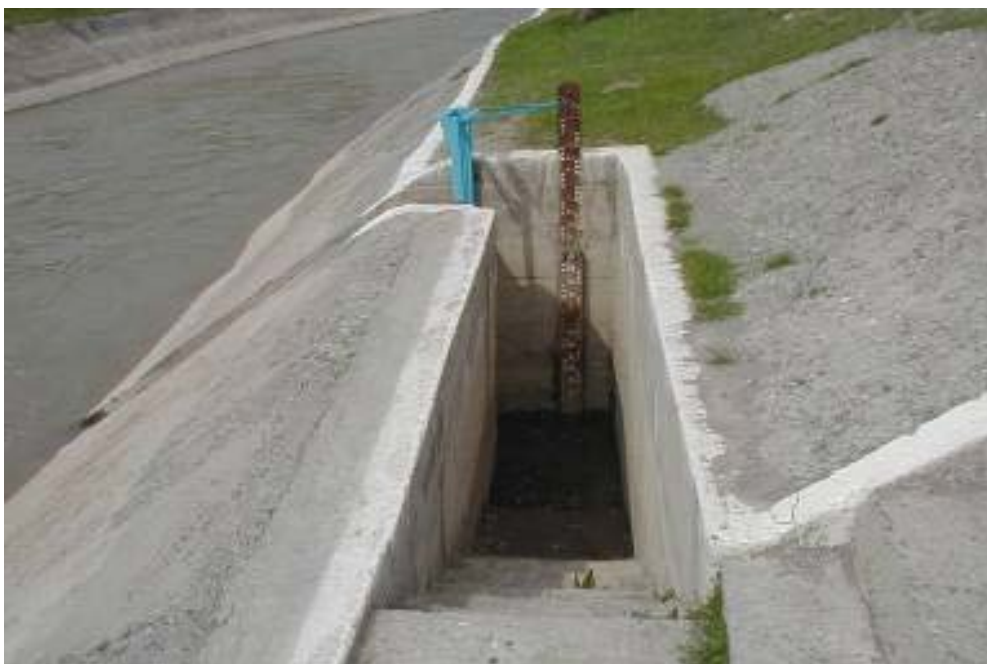
Рис. 3. Успокоительный колодец с гидротехнической рейкой
